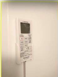
浴室乾燥換気扇
